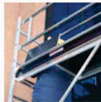
Bei Verwendung der Klappe kann in Sicherheit aufgestiegen werden. Grâce à l'utilisation de la trappe, on monte en toute sécurité.
